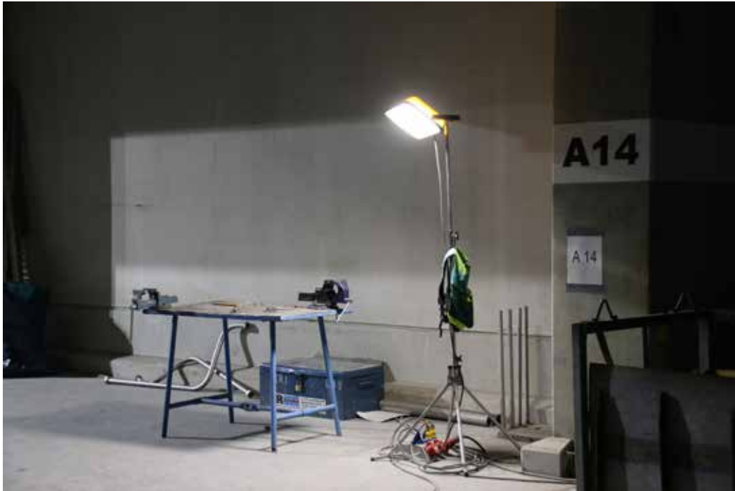
Tillfällig arbetsplats på större bygge här upplyst av Magnum 50W art.nr 553550 på stativ art.nr 550050
